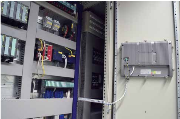
WP1703_3: Ein Panel-PC der ARCHMI-Serie von Wachendorff wurde in der Tür des Schaltschranks installiert. Der Panel-PC hat viele Schnittstellen bereits integriert.
