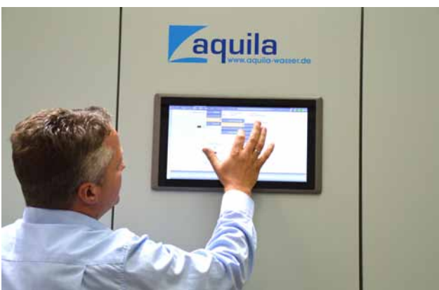
Abbildung WP1605_3: Die selbst erstellte Visualisierung „AT Suite“ läuft auf einem Panel-PC im Schaltschrank und kann via eWON-Fernwartung auch von Ferne bedient werden.
