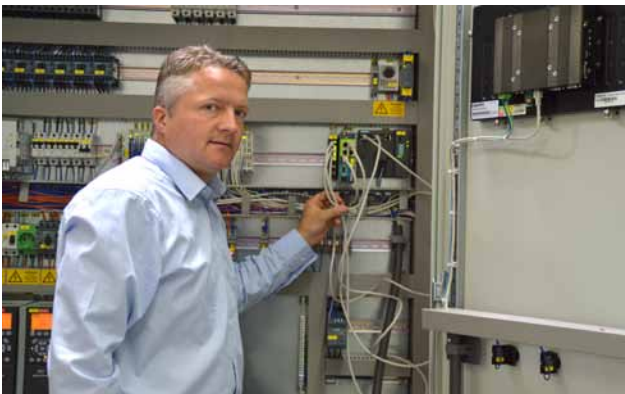
Abbildung WP1605_1: Frank Weiß, Autech Tesla vor einem Schaltschrank, der gerade in der eigenen Werkstatt zusammen gebaut wird. Auch hier kommt wieder der eWON-Fernwartungsrouter von Wachendorff Prozesstechnik zum Einsatz.
